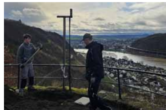
Ein Stützpfeiler für die Sonnensegel musste neu einbetoniert werden. Die schöne Aussicht entlohnt die Helfer
